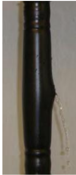
Figura 3.6 – Ruptura de tubagem multicamada, por excesso de pressão (Cotrim & Russo, 2009).
