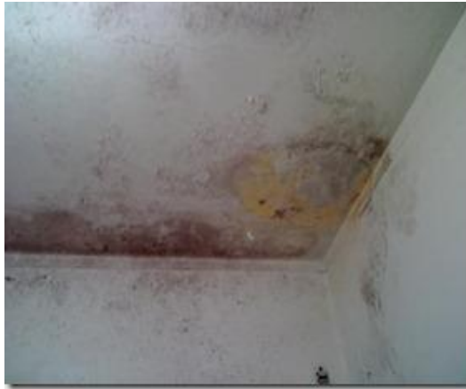
Figura 3.1 – Exemplo de manchas de humidade devido a perda de estanquidade de tubagens embutidas. (Reprodução de (Dicas Caseiras, 2013)).
