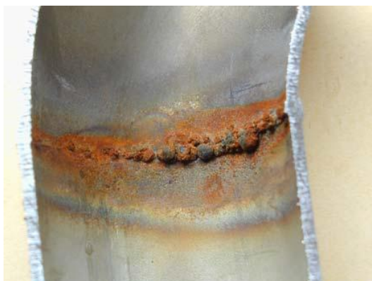
Figura 3.4– Corrosão intersticial (Adaptado de (Pedroso, 2006).
