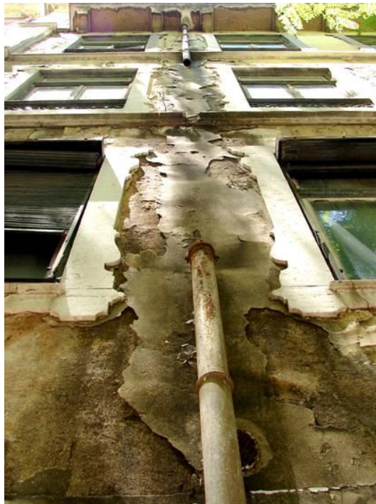
Figura 3.9 – Sistema de drenagem de águas pluviais degradado
