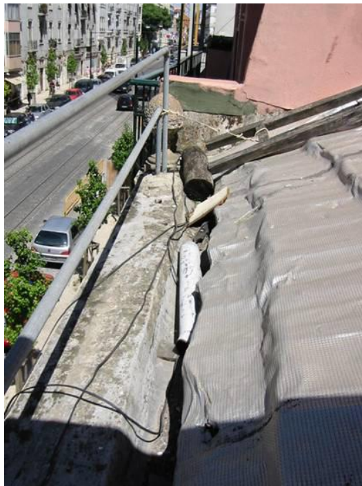
Figura 3.10 – Detritos acumulados em caleiras de recolha de águas pluviais (Pedroso, 2006).
