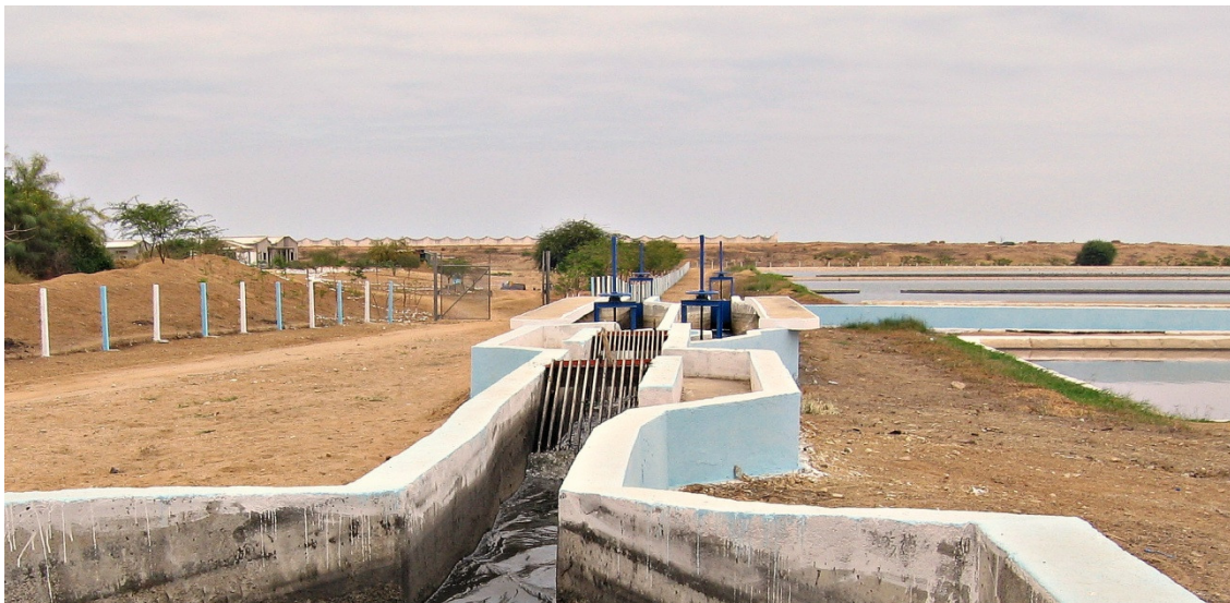
Figura 4.2.- Grelhas para o tratamento preliminar na bacia de oxidação de Benguela (fotografia tirada pelo autor)
