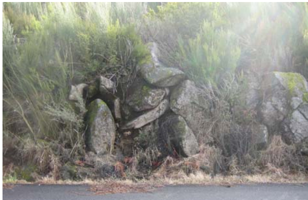
Est. 25 Material transportado por uma ravina na estrada que liga as povoações de Pensalvos a Parada de Monteiros. Parte do material tinha sido retirado da estrada após a queda de uma forte chuvada do dia 23 para 24 de Janeiro de 2009 pelos bombeiros que nos relataram a situação de perigo.
