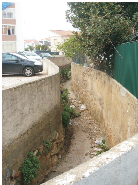
Fot. 5 - Alapraia, São João do Estoril. Encanamento da valla a jusante da rua da fotografia anterior. Claramente subdimensionado, o leito artificial mostra bem até onde, com mais frequência, chegam as águas – caso típico de agravamento de um hazard .
