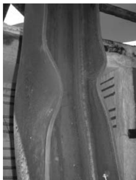
a) local buckling
