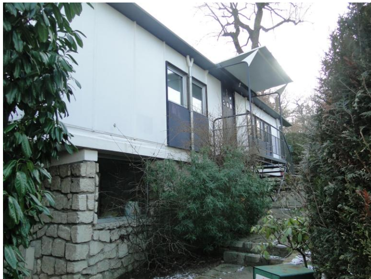
Imagem 89 e 90 – Casas tipo Standard em Meudon. Para vencer um terreno irregular as casas tiveram de recorrer a estruturas em alvenaria que em alguns casos atingiram os dois pisos.
