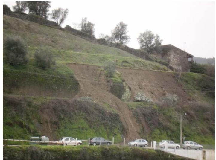
Figura 25 – Deslizamento de terras junto à EN222, Janeiro de 2010
