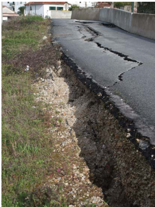
Figura 24 – Abatimento e facturação do pavimento da variante de Cambres devido ao deslizamento do talude de suporte, Abril de 2010
