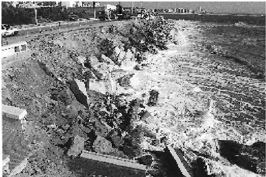
Foto 4 - Aspecto da destruição do enrocamento da Marginal Oceânica, junto do cemitério de Buarcos (troço Teimoso-Buarcos), durante uma preia-mar de maré viva (altura de 3,8 m Z.H.) e com fraca ondulação (1,5 m de altura) de WNW (9/03/1997). São visíveis os blocos de calcário branco depositados recentemente, mas que não impediram o desmoronamento progressivo da própria estrada marginal. Note-se a completa erosão do prisma arenoso da praia, que atingia 2,5 m de espessura na antiga frente do enrocamento, aflorando o substrato rochoso do Jurássico Superior. Em primeiro plano estão os destroços de uma escadaria de acesso à praia.
