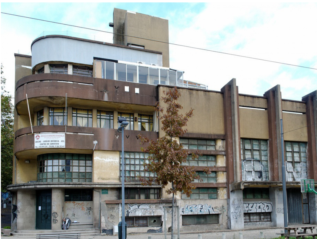
↖ Fig.36 Alçado dos Arm. Frig. de Massarelos, Porto. ↗ Fig.37 Vista dos Arm. Frig. de Massarelos. Porto ← Fig.38 Vista dos Arm. Frig. de Massarelos. Porto. ↓ Fig.39 Vista dos Armazéns Frigoríficos de Massarelos. Porto. Equipamento cristalizado.
