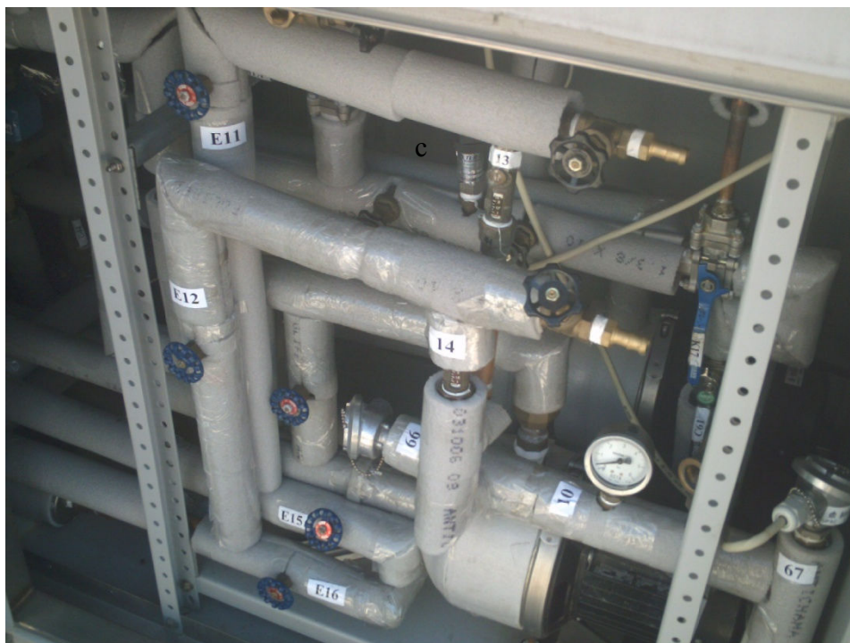
Parte do sistema hidráulico com ambas as bombas fazendo a água do sistema circular. Em baixo à direita está um termo-resistor.
