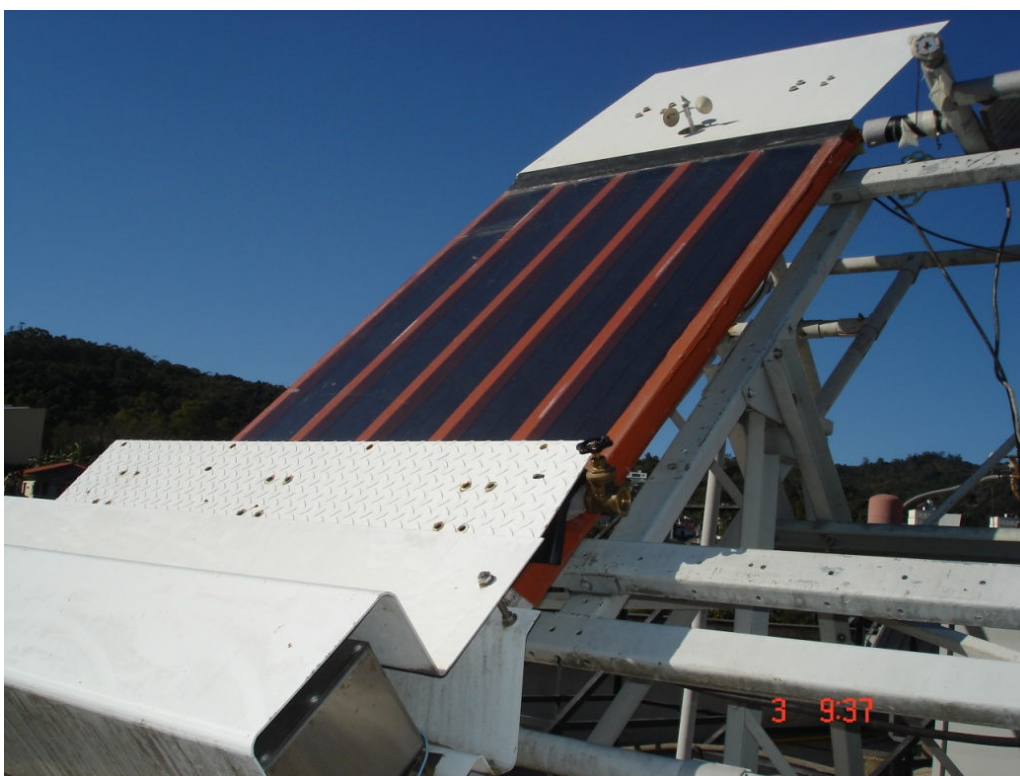
Figura 4 - Colector Solar incorporado na telha metálica instalado na Banca de Ensaios.
