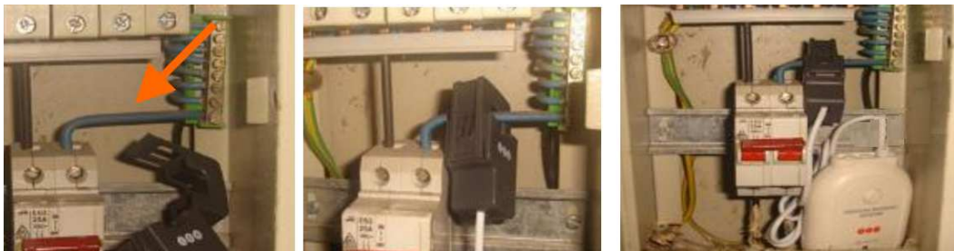
Figura D.2 – Colocação do sensor e do transmissor à volta do condutor geral neutro.
