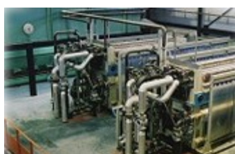
Figura 1.9 – Filtros Putsch existentes na Sidul Açúcares.
