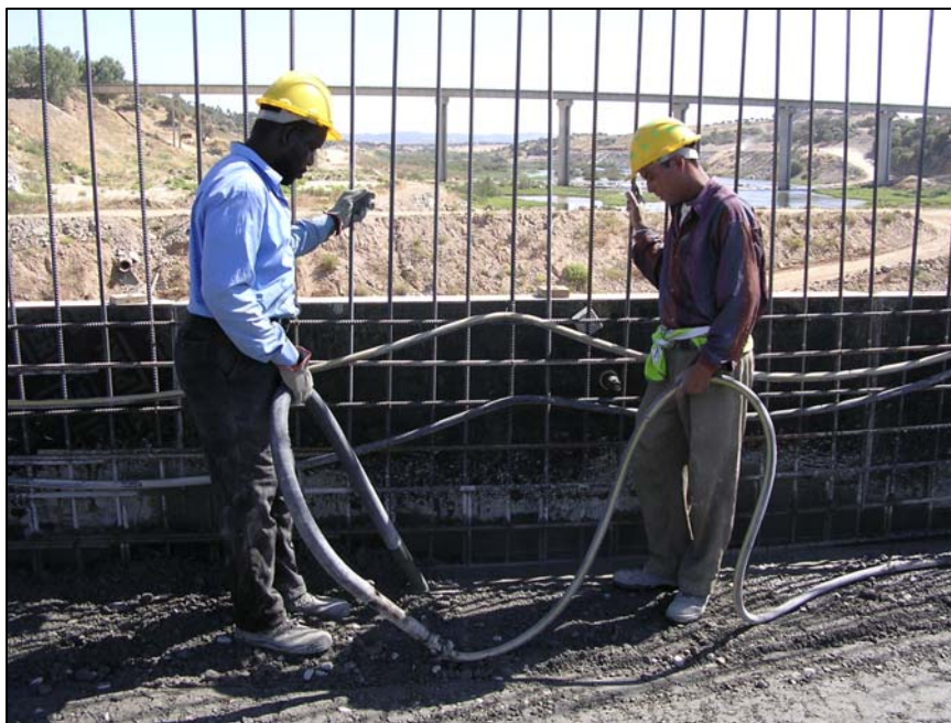
Fotografia 10. Imigrantes a trabalharem na construção civil, sub-sector onde é comum a realização de horas extraordinárias (Região do Alentejo)
