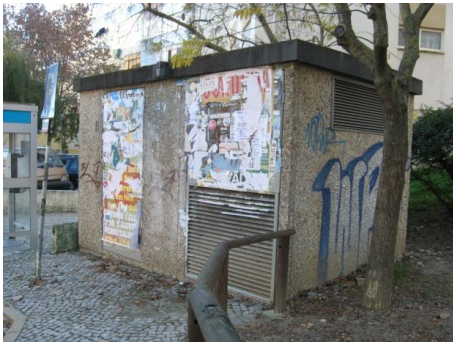
Figura 7 – Edifício de transformação
