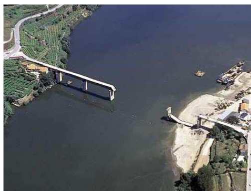
Imagem 9. Vista aérea da ponte Hintze Ribeiro pós-colapso, com a barra do lado direito da imagem
