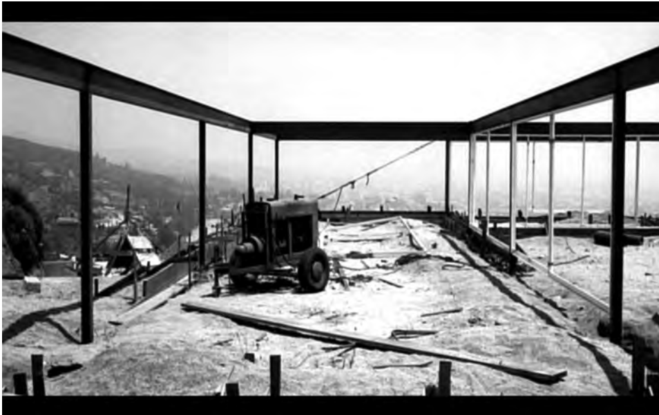
↑ Estrutura da Stahl House na fase de início dos trabalhos de construção.
