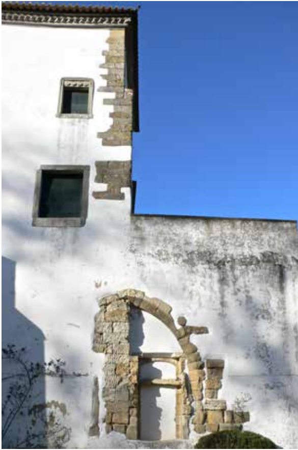
Fig. 75 - Vestígios de um arco quebrado na fachada sul do paço (2012, fotografia da autora)
