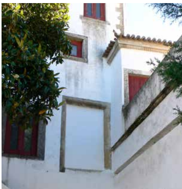
Fig. 163 - Porta emparedada no torreão das escadas (2012, fotografia da autora)
