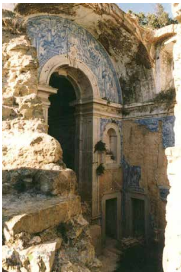
Fig. 240 - Ruínas da Capela do Senhor da Serra (fonte: SIPA)
