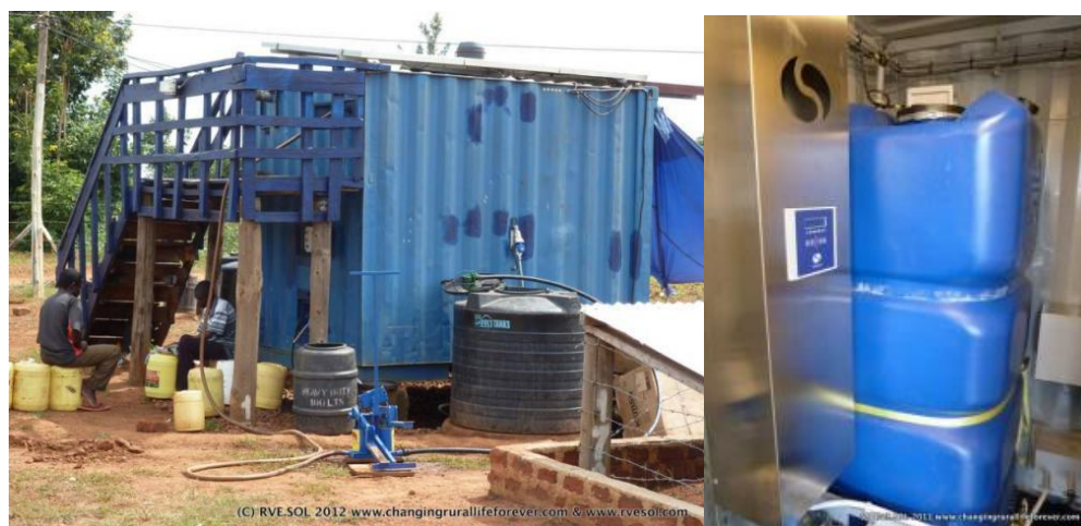
Figura 4.5- Bomba e reservatório exterior com água não tratada (à esquerda) e reservatório interior com água potável (à direita) (RVE.SOL, 2011/2013a)
