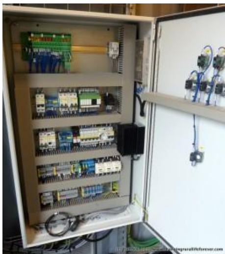
Figura 4.8 - Sistema de monitorização no interior do Kudura (RVE.SOL, 2013a)
