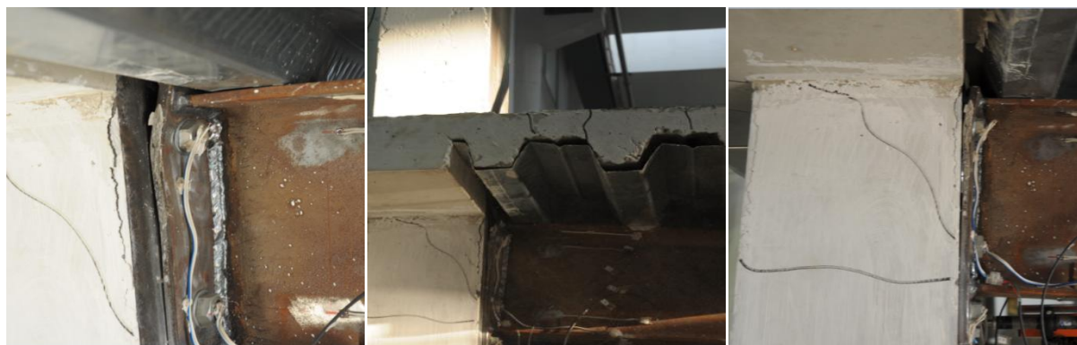
Figura 3.6 - Deformação da ligação após ensaio realizado à temperatura ambiente.
