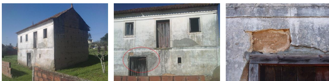
Figura 2.1 – Aplicação incorreta do reboco face ao suporte (Duarte, 2011).
