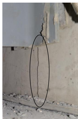
Figura 4.30 – Fissura de corte em fase mais avançada, do TPU em betão C25/30
