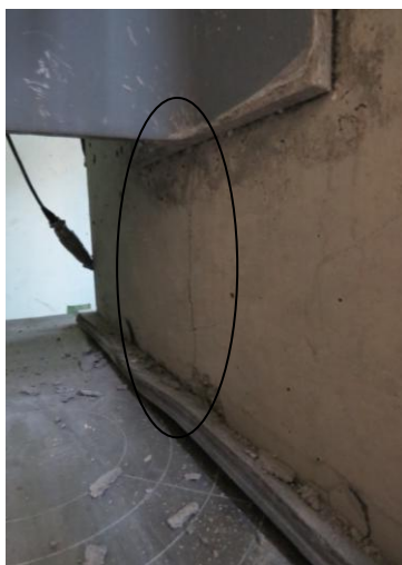
Figura 4.29 – Fissura inicial de corte do TP em betão C25/30
