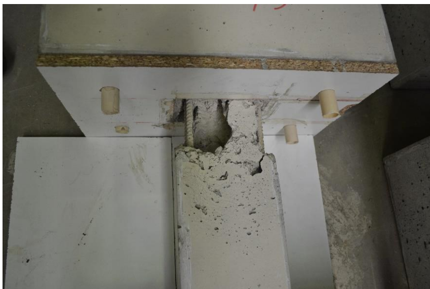
Figura 4. 30 - Defeito construtivo no Provete 5 .
