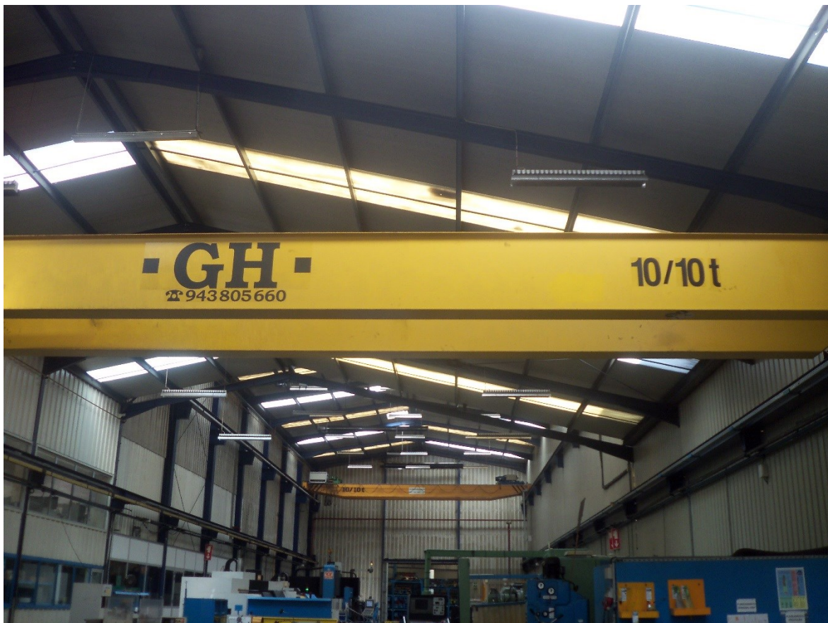
Figura 2.5. Imagem da ponte rolante na zona de manutenção da ferramentaria na Gestamp Aveiro .
