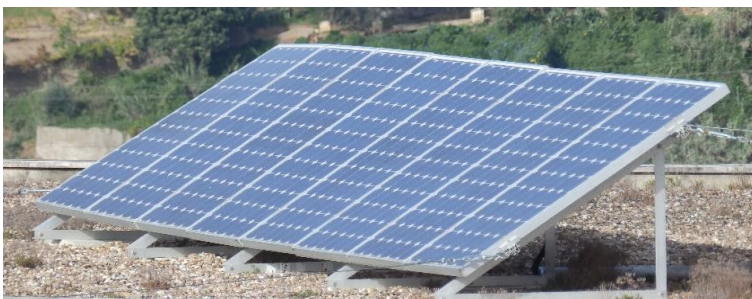
Figura D.14 - Painéis fotovoltaicos
