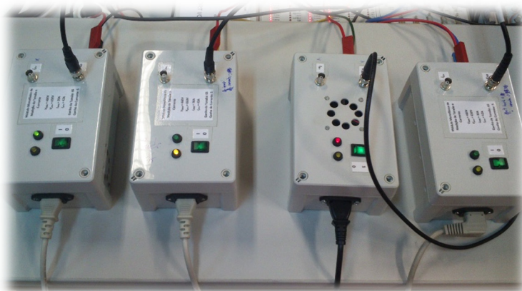
Figura D.13 – Conjunto de sensores monofásicos, utilizados para monitorizar a tensão nos condensadores.
