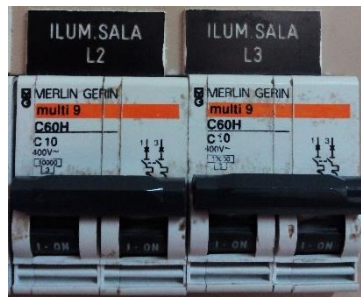
Figura A.1 - Disjuntores de iluminação do LGE
