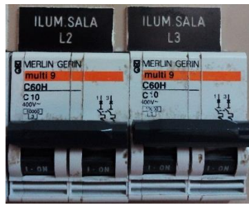
Figura C. 1 - Disjuntores de iluminação do LSE
