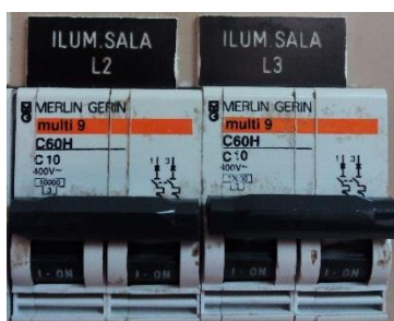
Figura B.1 - Disjuntores de iluminação do LEP
