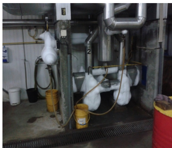
Figura 16 – Formação de gelo e calhas técnicas com cabos elétricos, na empresa A
