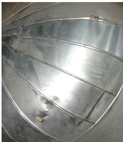
Figura 15 - Danos no depósito de fluidos da empresa A
