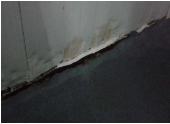
Figura 21 - Deterioração junto ao rodapé de uma das câmaras de refrigeração da empresa A
