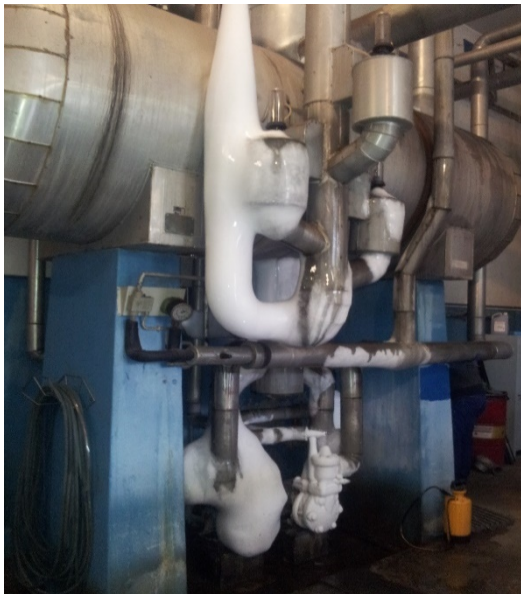
Figura 17 - Formação de gelo na tubagem da empresa B
