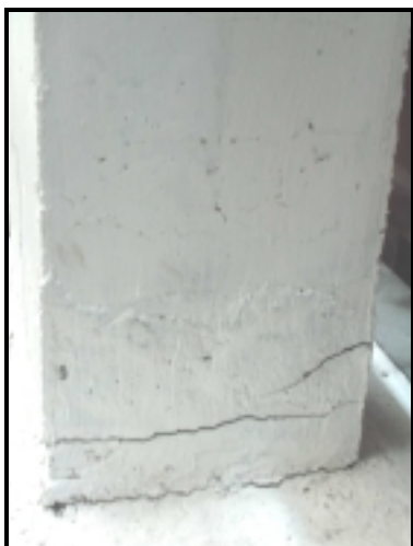
Fotografia 5.1 (c) - Fissuração da face traccionada do modelo M3G2.
