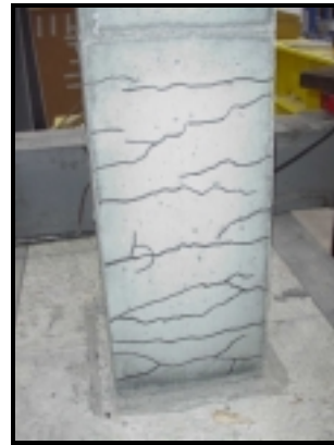
Fotografia 3.10 (b) - Propagação das fissuras existentes e surgimento de novas fissuras.
