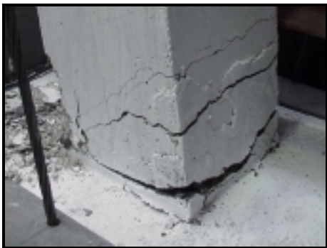
Fotografia 4.3 (c) - Fissuração da zona do encastramento do modelo M3G1.
