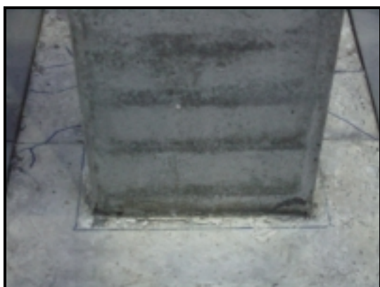
Fotografia 3.8 (d) - Ligeiro esmagamento do betão da face comprimida.
