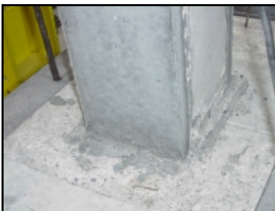
Fotografia 3.10 (c) - Ligeiro destacamento do betão na face comprimida junto ao encastramento.
