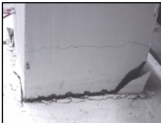
Fotografia 5.1 (d) - Fissuração da face traccionada do modelo M4G2.
