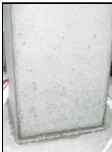
Fotografia 5.1 (f) - Fissuração da face traccionada do modelo M6G2.
