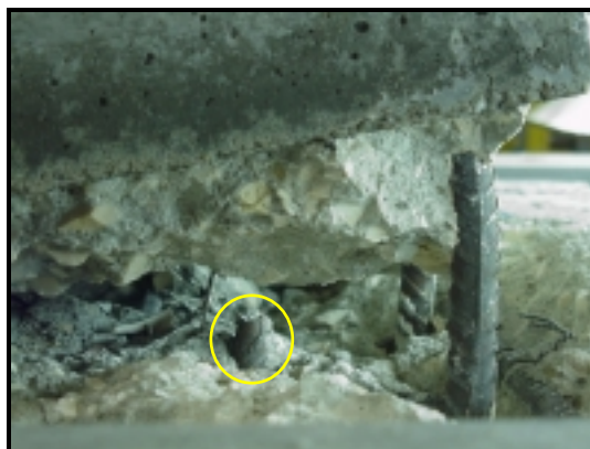
Fotografia 3.8 (c) - Ruptura dos varões traccionados da armadura longitudinal do modelo original.
