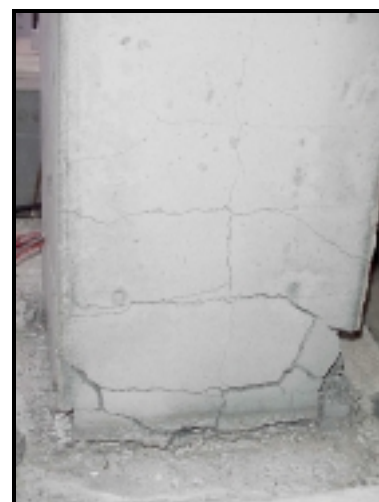
Fotografia 5.1 (b) - Fissuração da face traccionada do modelo M2G2.
