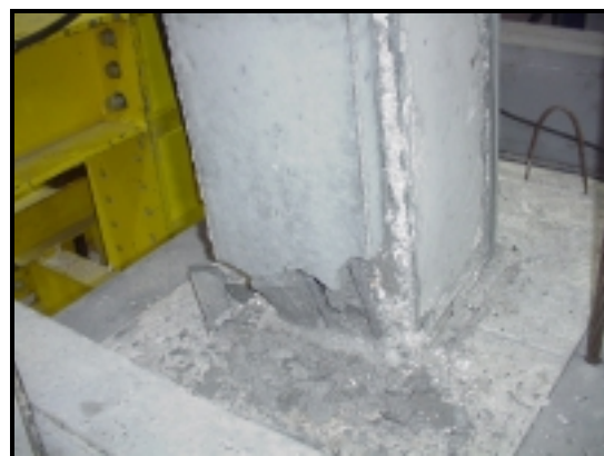
Fotografia 3.10 (d) - Destacamento total com a encurvadura dos varões comprimidos da armadura do reforço.
