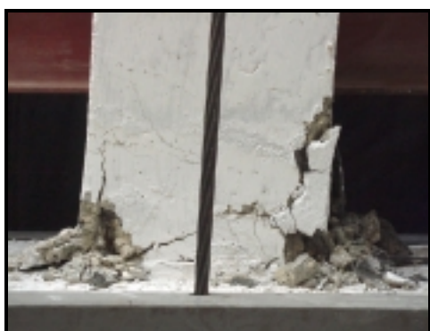
Fotografias 5.2 (c) - Fissuração da zona do encastramento do modelo M3G2.
