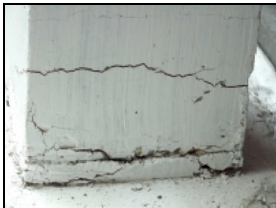
Fotografia 5.1 (a) - Fissuração da face traccionada do modelo M1G2.
