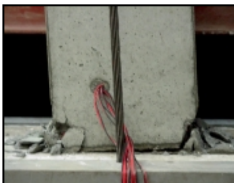
Fotografias 5.2 (f) - Fissuração da zona do encastramento do modelo M6G2.
