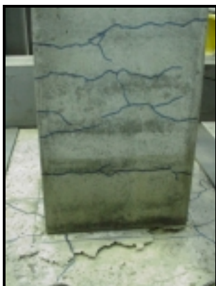
Fotografia 3.8 (a) - Fissuração da face traccionada.
