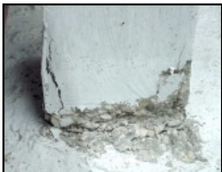
Fotografia 4.2 (a) - Fissuração da face comprimida do modelo M1G1.
