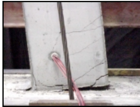
Fotografia 4.3 (b) - Fissuração da zona do encastramento do modelo M2G1.
