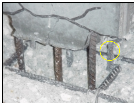
Fotografia 3.10 (g) - Escorregamento dos varões traccionados da armadura longitudinal do reforço e estiramento dos varões traccionados da armadura longitudinal do modelo.
