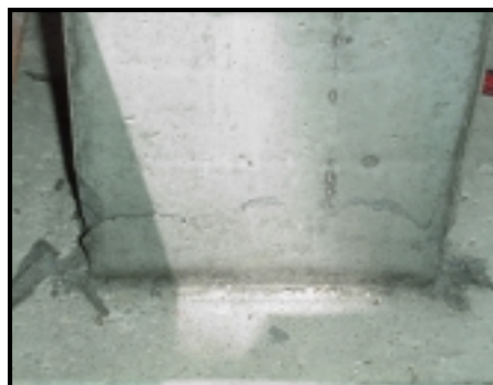
Fotografia 4.2 (f) - Fissuração da face comprimida do modelo M6G1.
