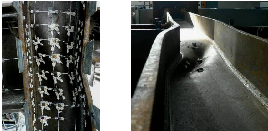
a) Deformação da junta
