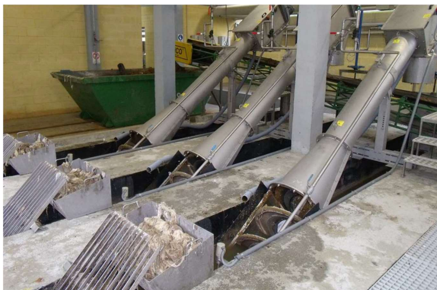
Figura 4.8 – Obra de Entrada da ETAR de Vila Real
