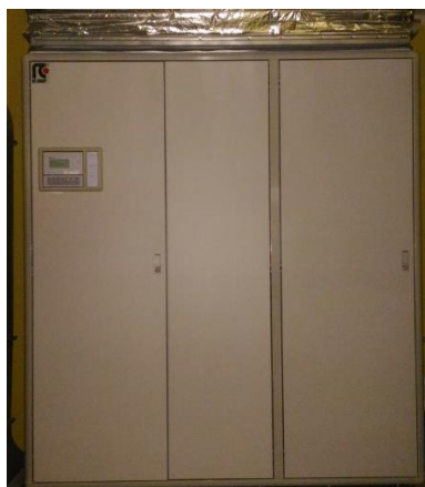
Fig. 48 – Unidade de desumidificação do tipo Close-Control
