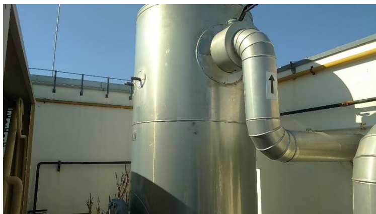
Fig. 18 – DIAF, localizado na cobertura
