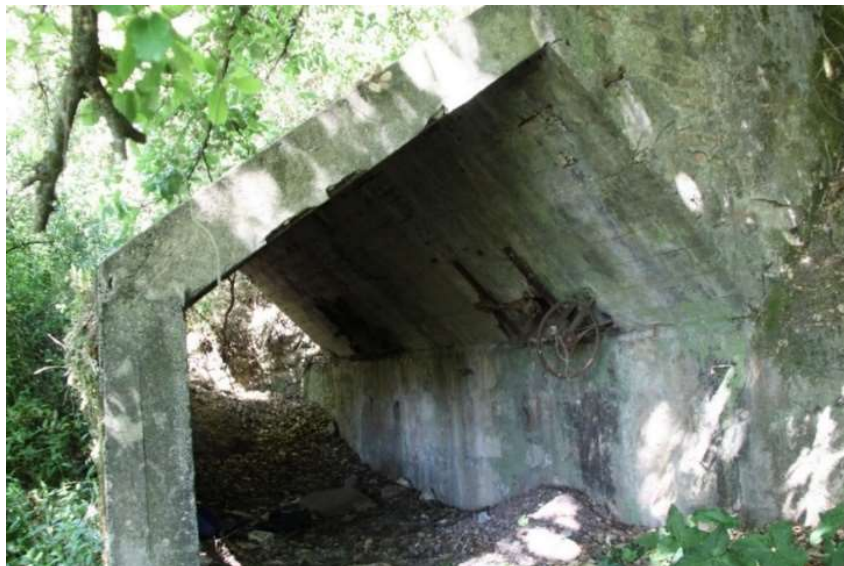
Fig. 26: Tegão de descarga do carvão.
