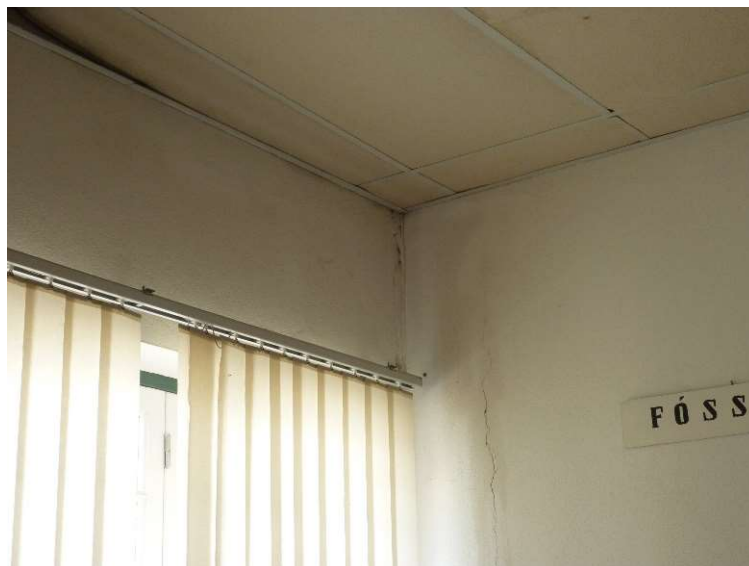
Fig. 18: Museu Municipal de Porto de Mós. Vista interior: visíveis problemas de excesso de luminosidade e de humidade.
