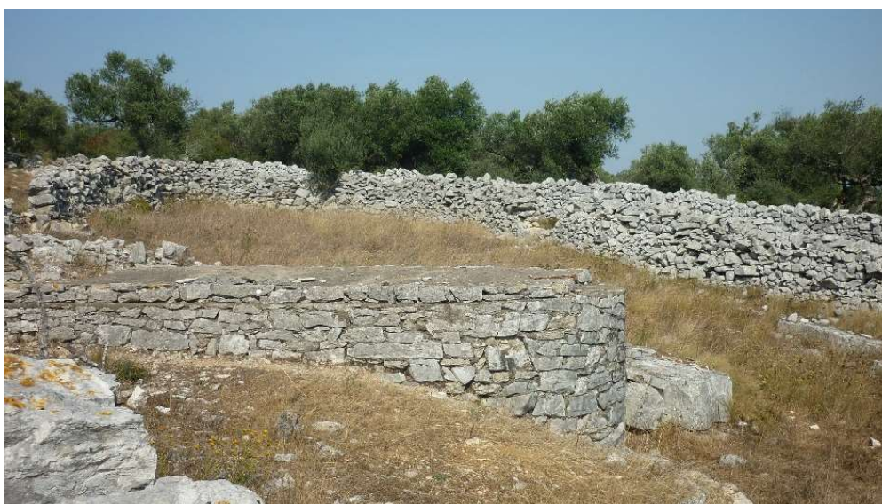
Figura 46: Cisterna, São Bento.
