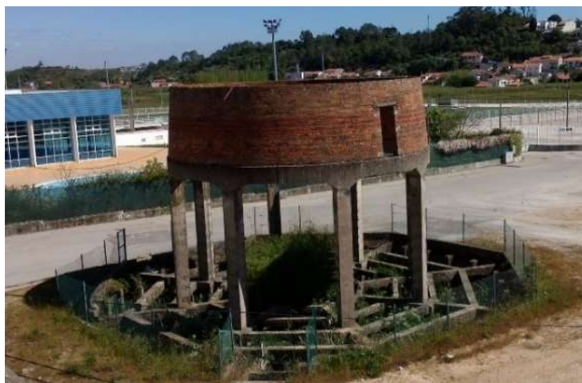
Fig. 25: Torre de Refrigeração da Central termoeléctrica de Porto de Mós.
