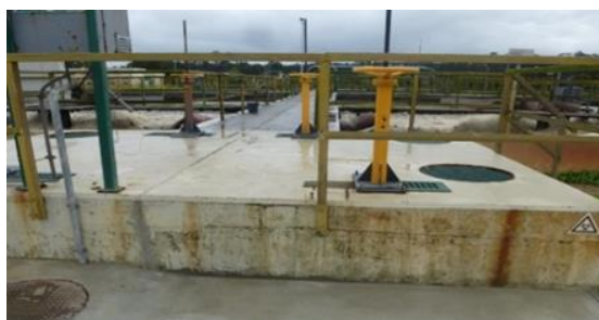
Figura 3.6 – Câmara a entrada do tanque de arejamento e as comportas. (ponto F6)
