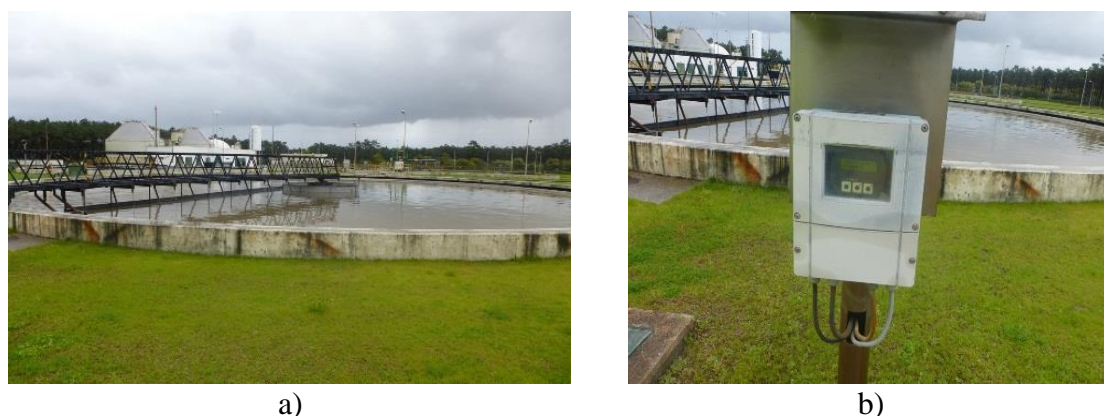
Figura 3.5 – a) Decantador primário 1 (ponto F4) e b) decantador primário 2 (ponto F5)
