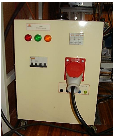
Figura F.1: Autotransformador usado para regular a tensão da rede.
