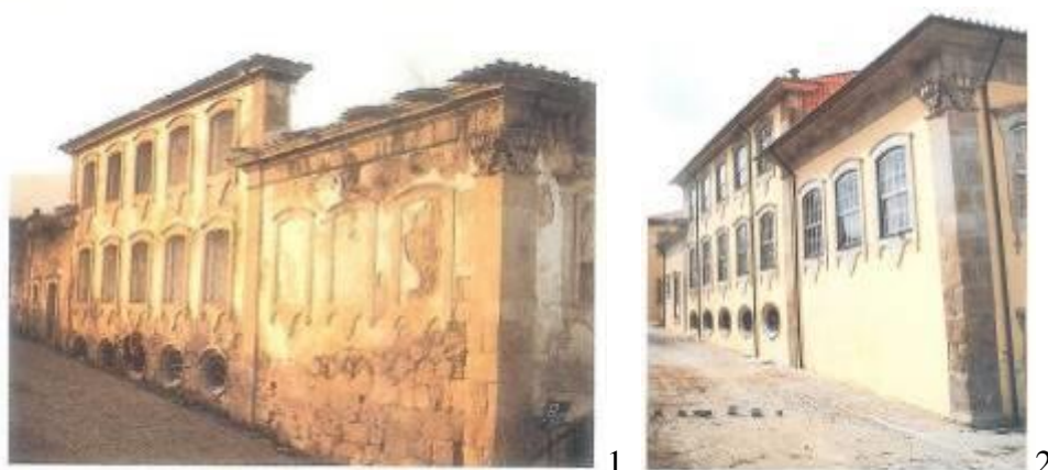
Fig.470 - 1 – Fachada lateral da casa dos Serpas ou casa de Santa Cruz em ruínas 521 . 2 - Fachada lateral da casa dos Serpas ou casa de Santa Cruz depois das obras de recuperação 522 .
