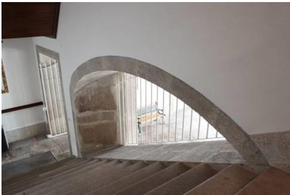
Fig.296 - Escadaria interna de um lance com arco de granito lateral interrompido. Fotografia da autora.
