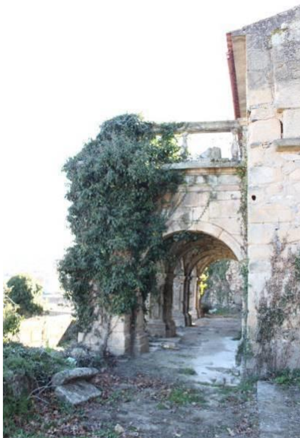
Fig.576 - Terraço no primeiro piso e galeria no rés do chão, na fachada posterior da casa do Alvão 633 . Alvelos, Lamego. Fotografia da autora.
