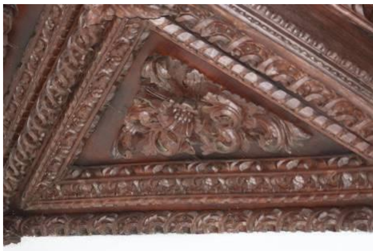
Fig.156 - Pormenor do padrão do teto em masseira, de motivos decorativos vegetalistas e geométricos relevados, do teto do salão, do 1.º piso, da casa do Assento ou Solar dos Padilhas. Fotografia da autora.
