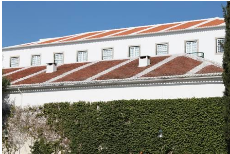
Fig.743 – Telhados da adeiga e dos lagares da Quinta da Pacheca. Fotografia da autora.
