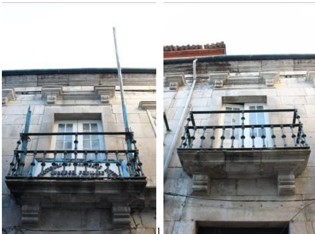
Fig.62 - 1 e 2 – Aspectos das varandas da fachada principal da casa dos Albergarias, casa da rua da Olaria 66 . Fotografias da autora.
