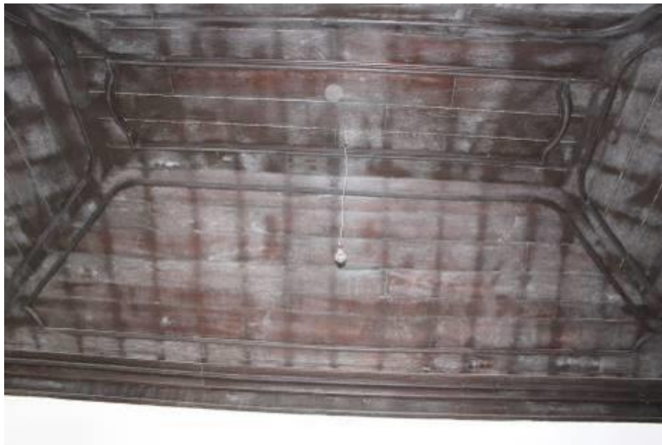
Fig.956 - Teto em masseira de sala no piso nobre (1.º piso) da casa do Montenegro 1. Fotografia da autora.
