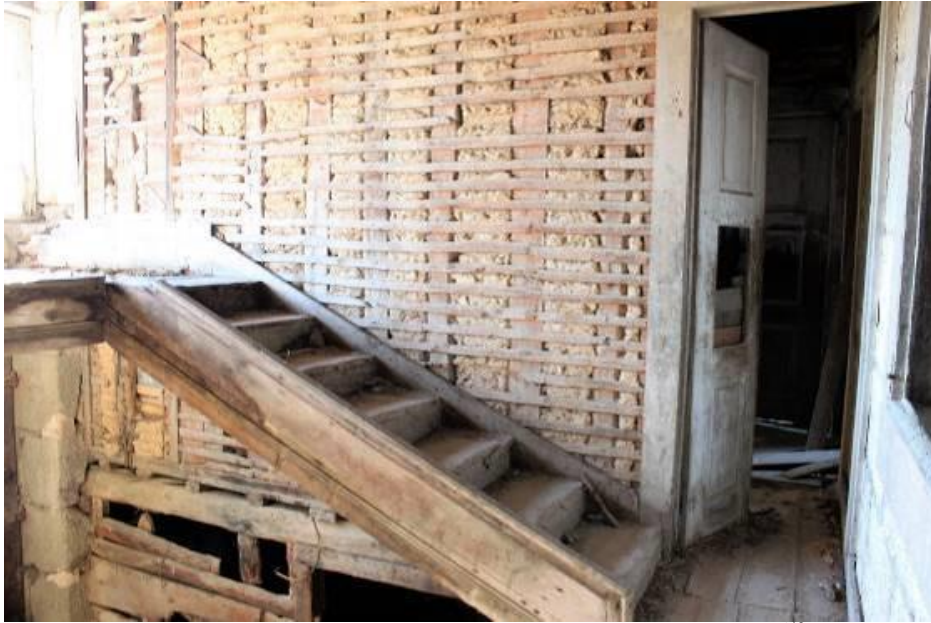
Fig.588 - Estrutura da parede em tabique, no interior da casa do Alvão 642 . Alvelos, Lamego. Fotografia da autora.
