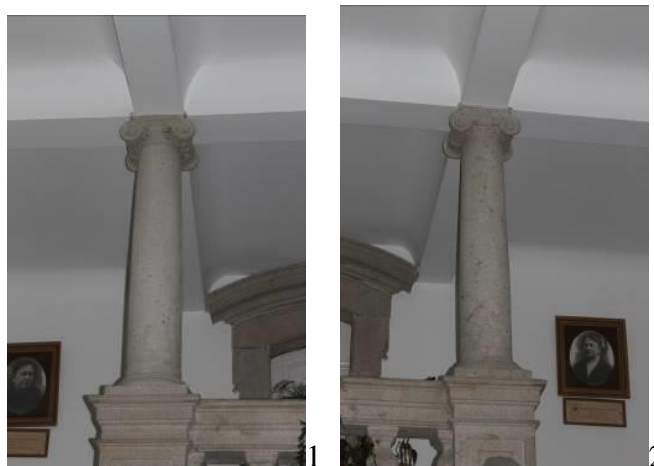
Fig.52 - 1 e 2 - Colunas com capitéis jônicos 54 , no patamar do 1.º piso. Fotografias da autora.
