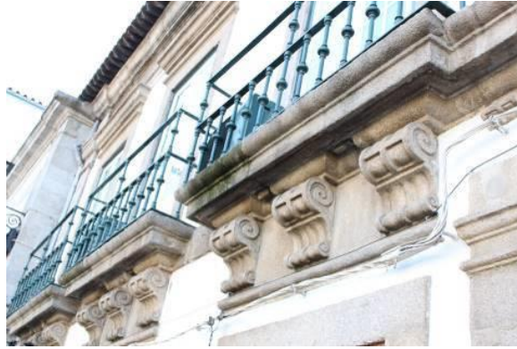
Fig.341 – Aspeto decorativo das varandas na fachada principal da casa da Viscondessa de Guiães 382 , 2013. Fotografia da autora.
