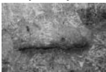
Figura 2.26 – Fissuração a frio (CMM, 2016)
