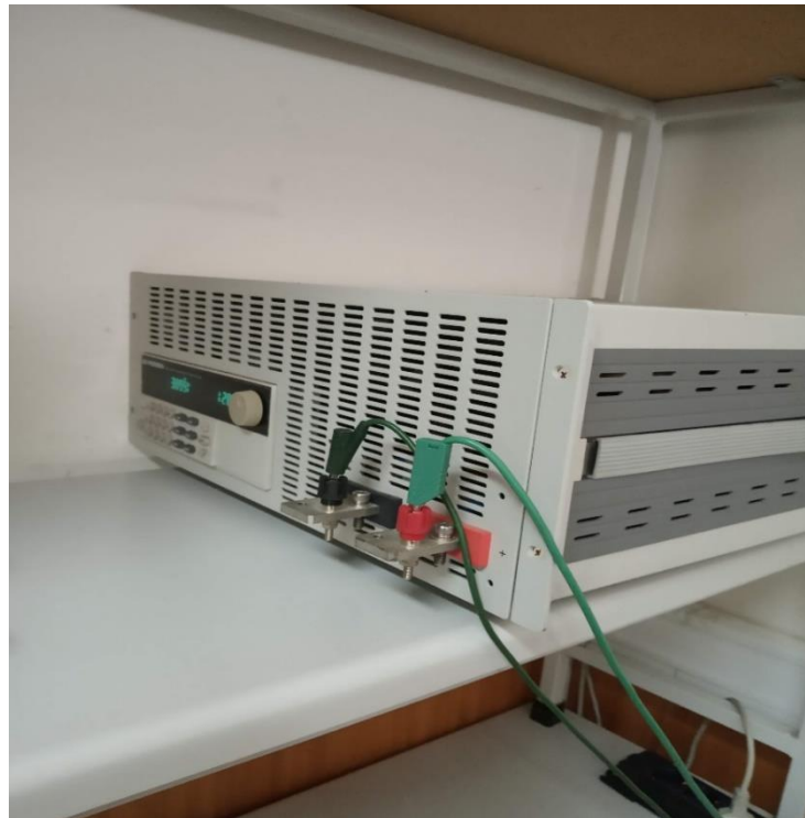
Fig. G. 13 – Carga DC de control.
