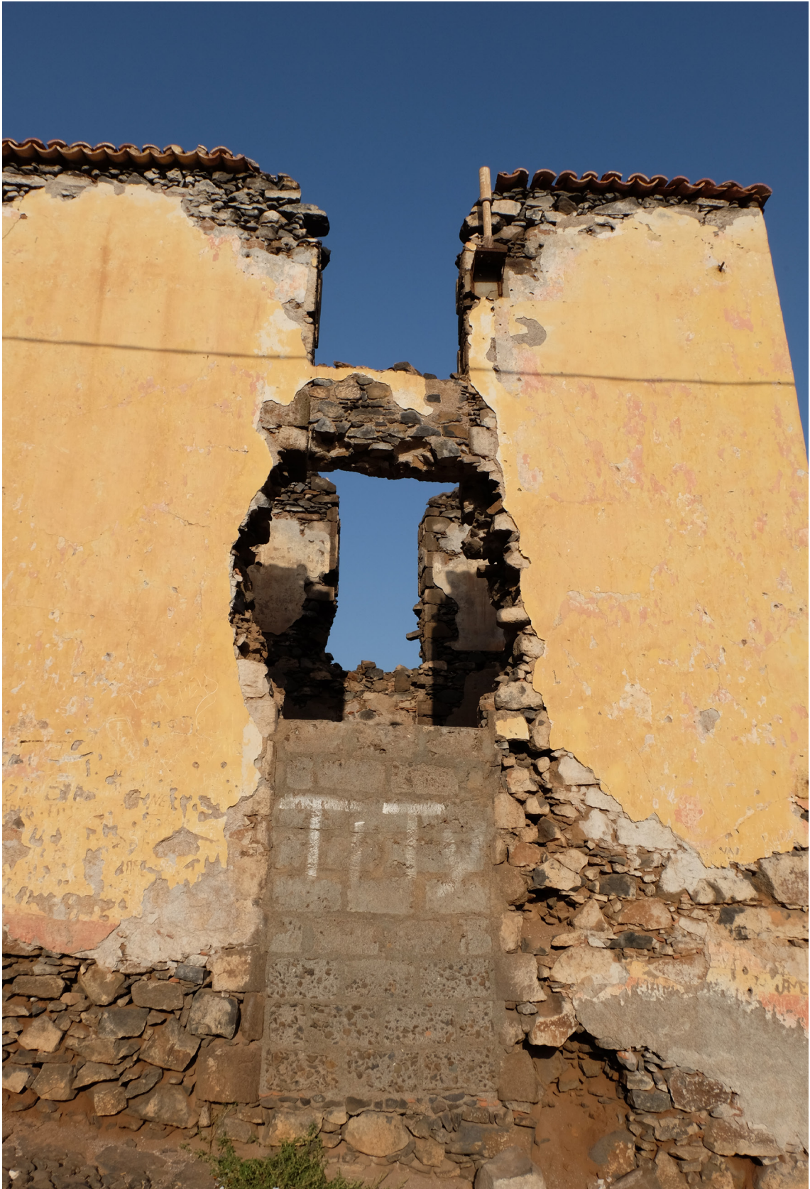
Anomalias nas paredes da ruína da antiga alfândega - José Mesquita
