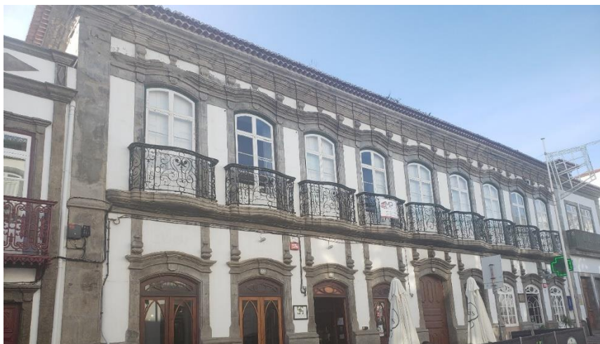
Figura 3-5 - Patologias da cantaria. @Arquivo fotográfico da DRAC.
