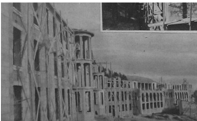
Fig. 937: Aspecto das obras em Julho deste ano. s/a. s/d. "A Luta contra a Tuberculose: O Sanatório Ferroviário da Covilhã" - in Diário de Notícias Ilustrado, 193-. ID_CD: IMAGEM_410.jpg
