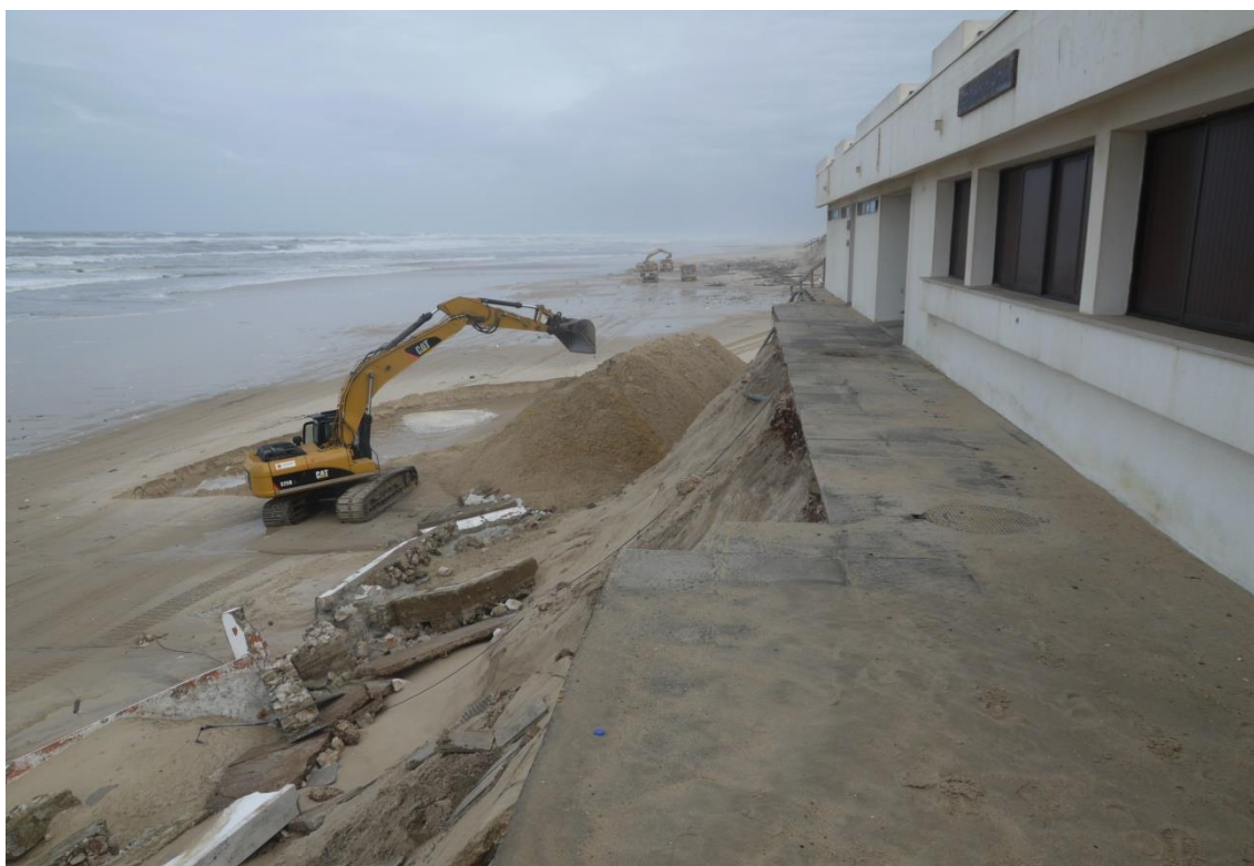
Fot. 51 – Muro defronte do Centro Azul da Praia do Pedrógão destruído pela ondulação (março de 2014).
