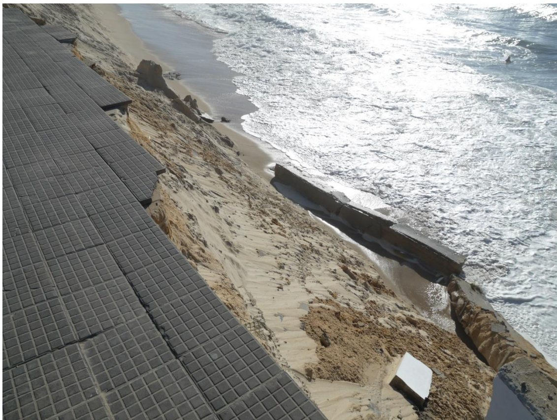
Fot. 50 – Destruição de parte da rotunda norte (março de 2014).
