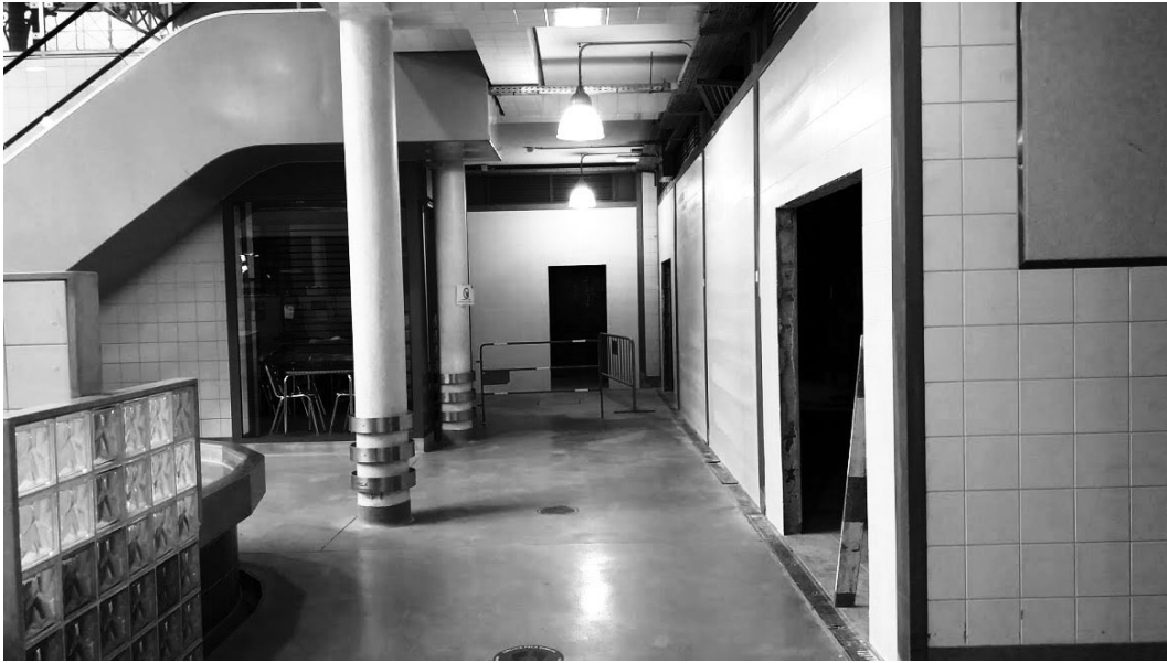
Figura 137 - Fotografia das novas obras - novo projeto de Refuncionalização do Mercado Municipal [Mercado do Peixe].
