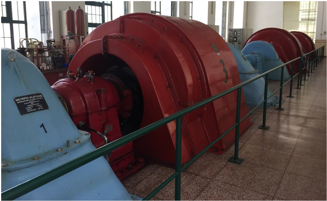
Figura C.15 – Grupo nº 3 da central Sabugueiro I.
