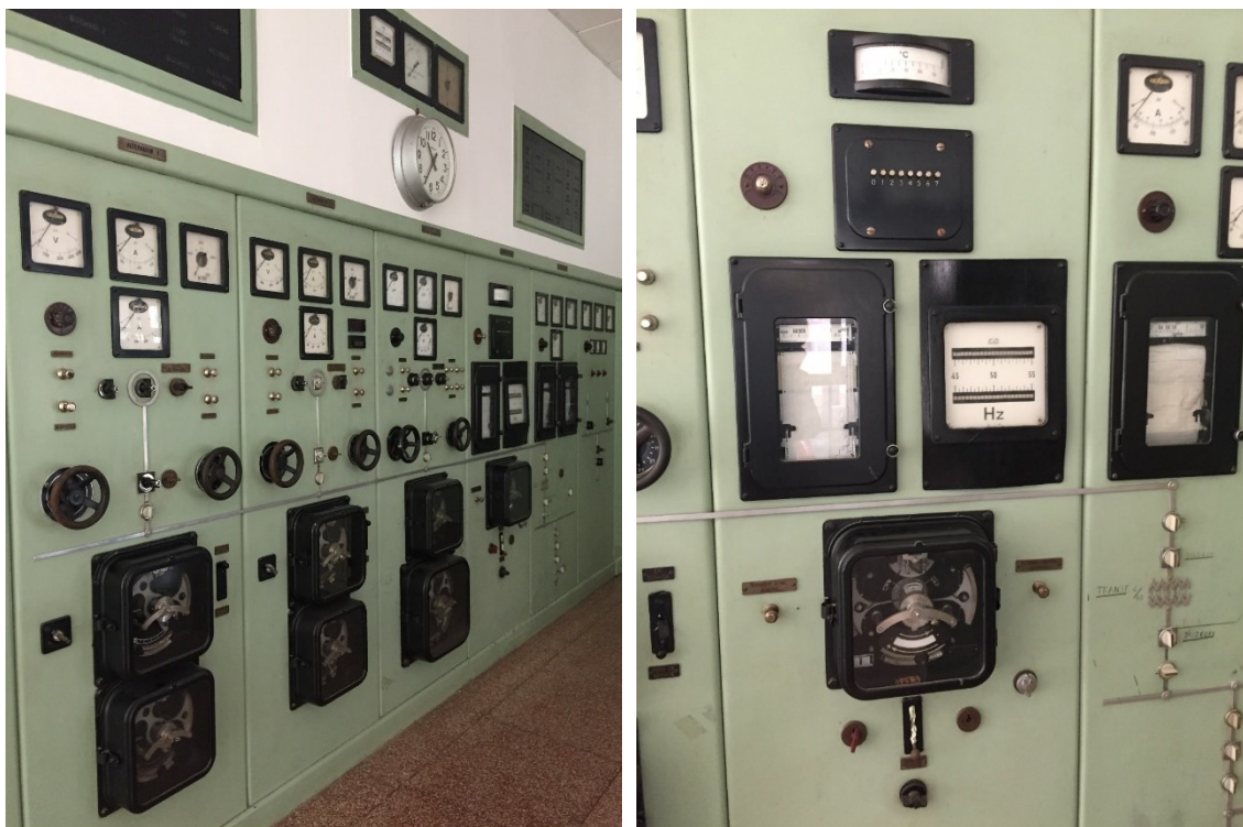
(a) (b) Figura 6.29 – Antigo quadro de comando e proteção da central de Sabugueiro I. (a) Vista parcial, (b) Pormenor de alguns equipamentos de medida.
