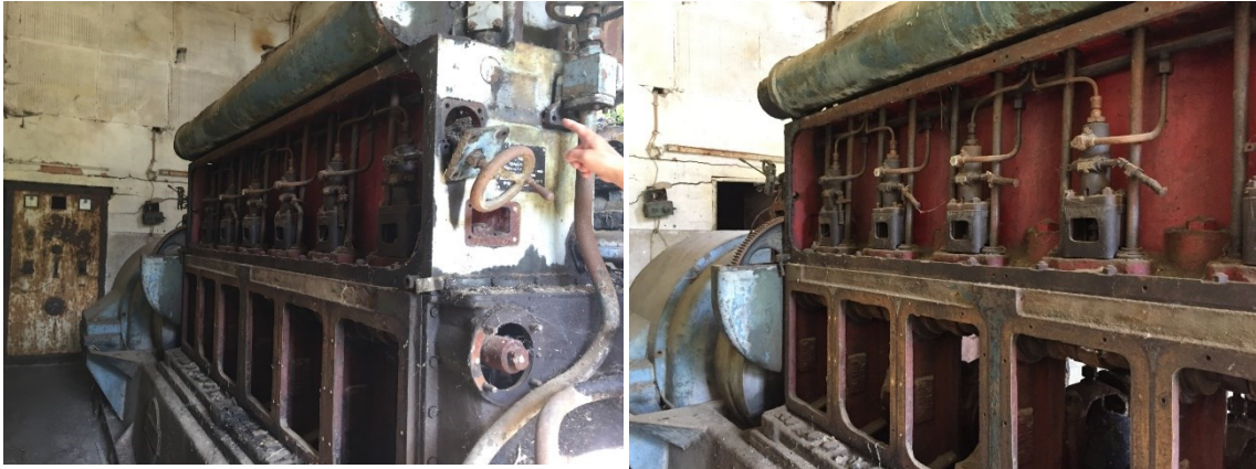
(a) (b) Figura 6.44 – Máquina de funcionamento a vapor existente na fábrica de S. Gabriel. (a) Vista geral, (b) – Pormenor.
