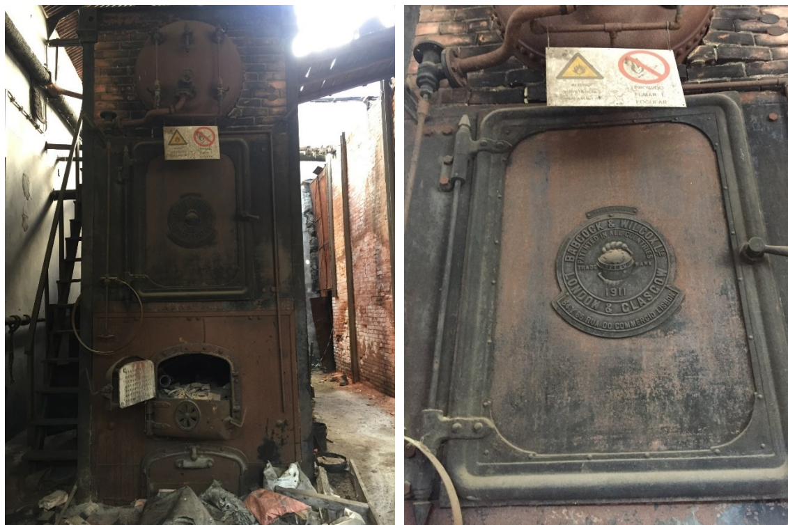
(a) (b) Figura 6.43 – Central de vapor da fábrica de S. Gabriel. (a) Vista geral, (b) – Pormenor do fabricante.
