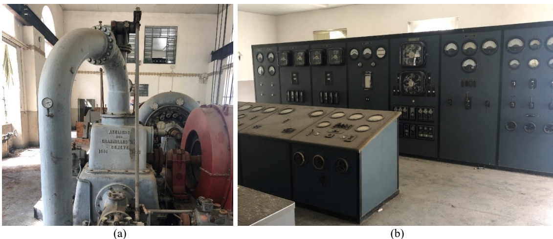
(a) Vista Grupo de turbina simples da Charmilles-Brown Boveri (b) Quadro de comando e manobra. Figura C.12 – Turbina Charmilles-Brown Boveri e quadro elétrico da central de Vila Cova.
