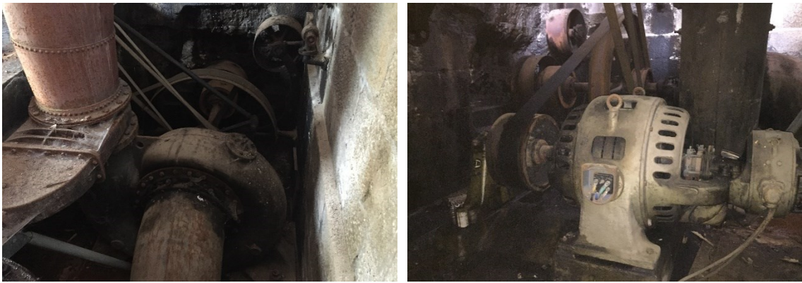
(a) (b) Figura 6.45 – Grupo gerador da fábrica de S. Gabriel. (a) Turbina, (b) – Gerador.
