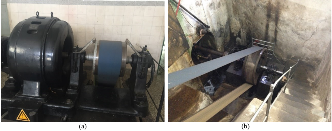
Figura 6.13 – Grupo de produção da central hidroelétrica de Riba-Côa.
