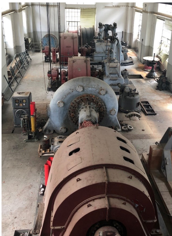
Figura 6.24 – Vista geral do interior da Central de Vila Cova.
