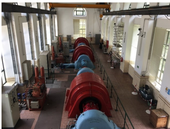
Figura 6.27 – Vista do interior da Central Sabugueiro I.
