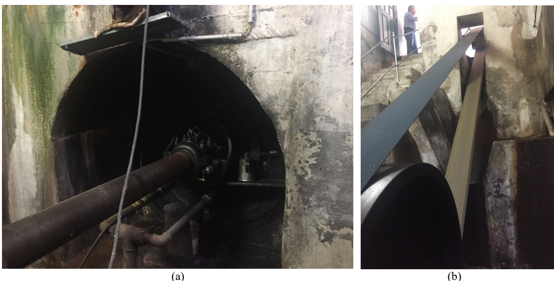
(a) Local de instalação da turbina (b) Ligação mecânica turbina-gerador
