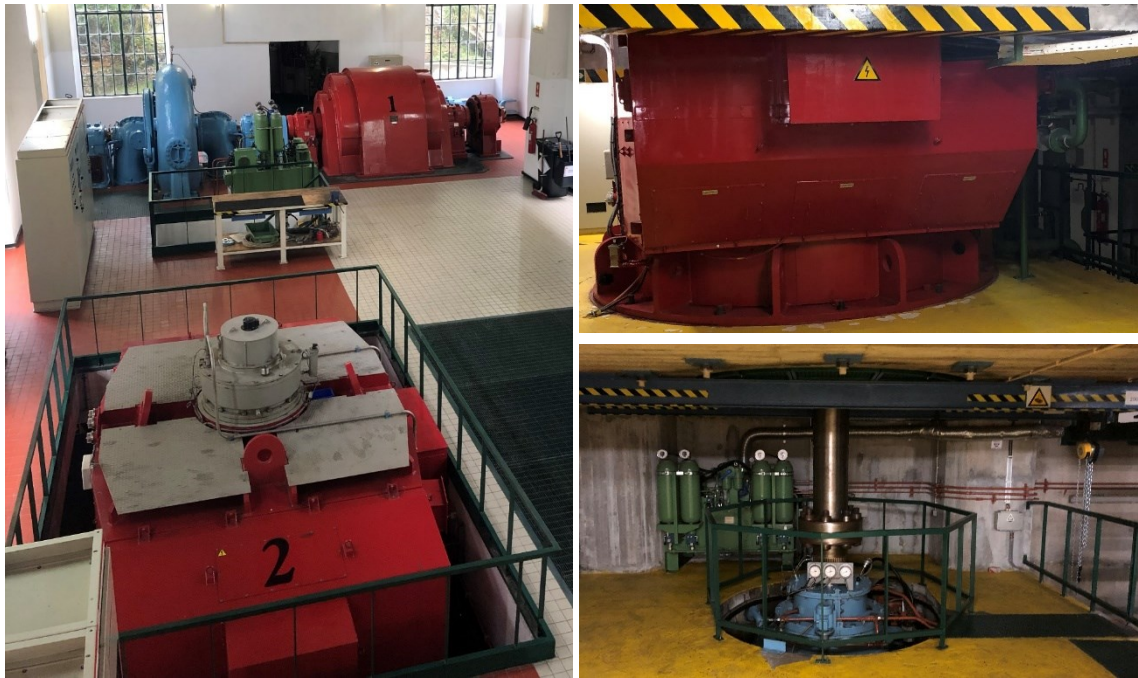
(a) (b)/(c) Figura 6.20 – Vista geral do interior da central hidroelétrica de Ponte Jugais. (a) Vista geral da sala de máquinas, (b) Gerador nº 2, (c) Turbina do gerador nº2.
