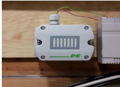
Figura 52 - Sensor de CO 2 adquirido instalado na câmara climática
