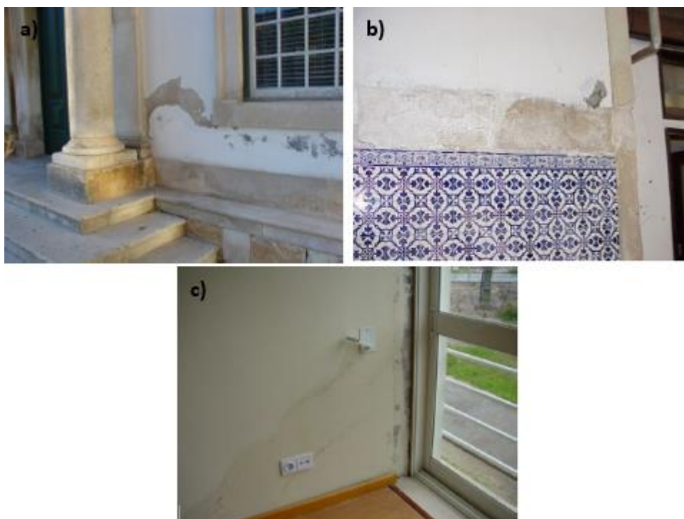
Figura 2.9 – Humidade ascensional: a) em edifício histórico, agravada pela presença de degrau com inclinação para o lado da parede b) Parede sujeita ao fenómeno, agravado pela impermeabilização parcial da face interior c) em edifício de construção recente, proveniente de águas exteriores infiltradas através do incorreto desempenho da soleira (Silva, J. A. 2010).
