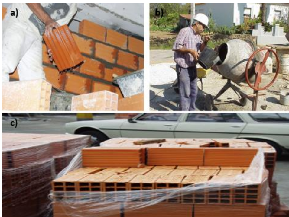
Figura 2.3 – Humidade na Construção a) excessiva molhagem do tijolo, na fase de assentamento b) Excesso de água nas argamassas c) Falta de proteção nos materiais no estaleiro (Silva, J. A. 2010)
