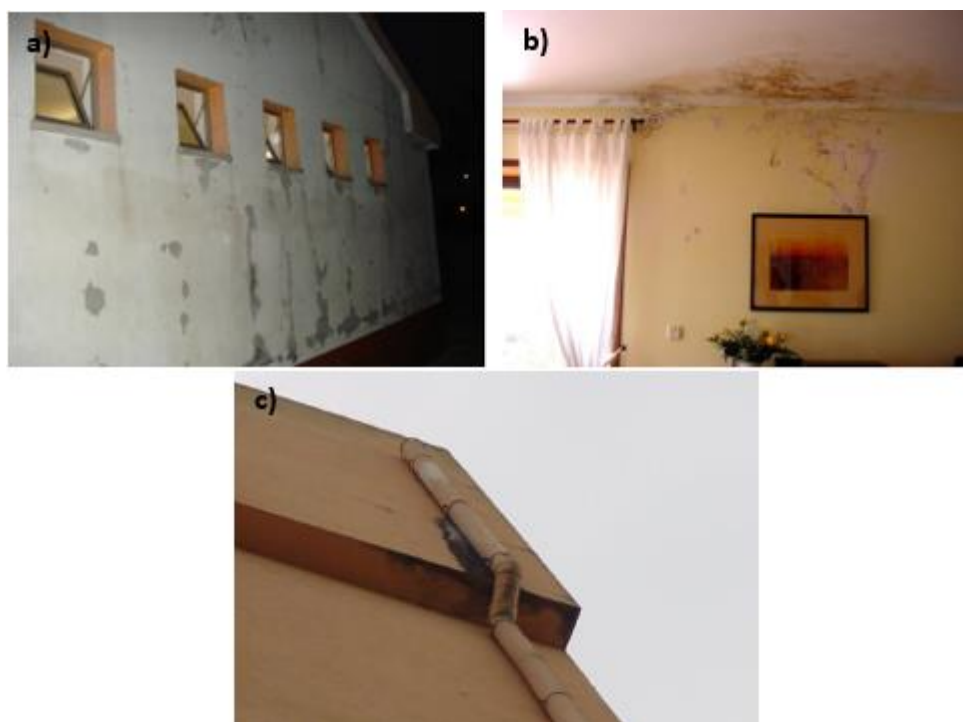
Figura 2.7 – Causas fortuitas a) Infiltração devido a rotura de canalizações b) Infiltração localizada e fortuita c) Infiltração pontual e fortuita (Silva, J. A. 2010).
