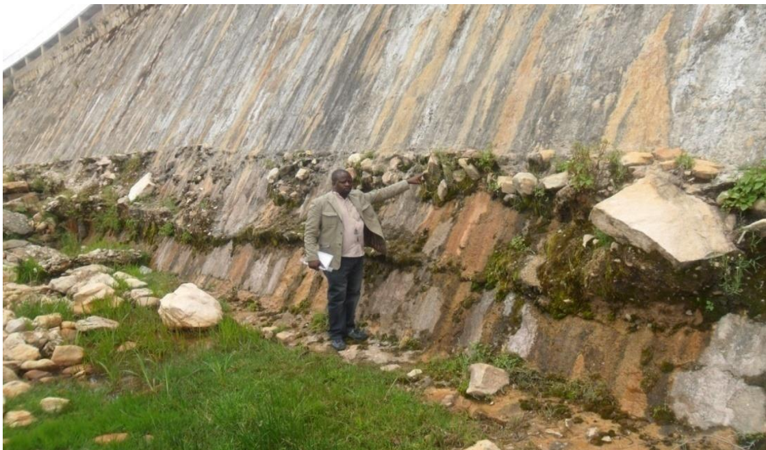
Figura 3.7. Erosão na base do paramento de jusante da barragem.
