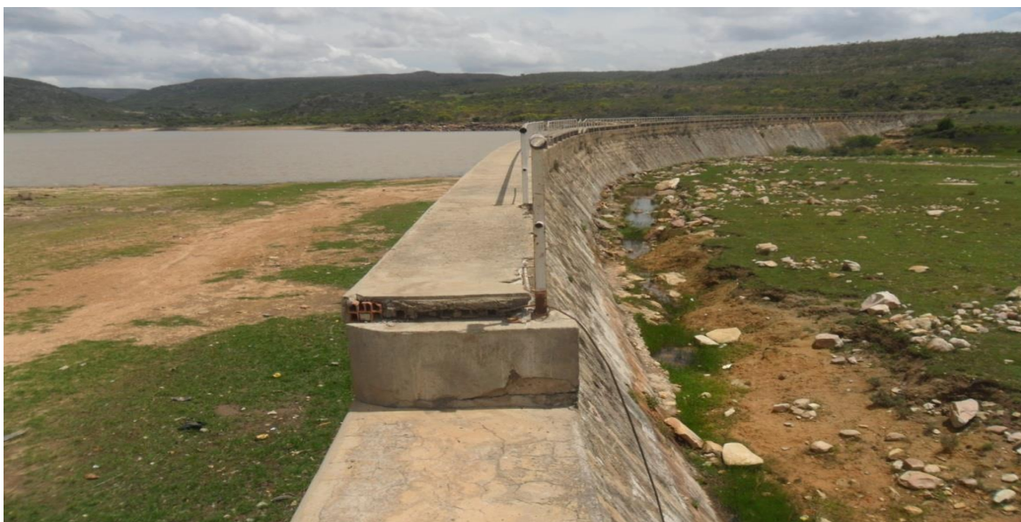
Figura 3.12. Barragem com o descarregador de cheias fraturado e com erosão no pé do paramento de jusante.
