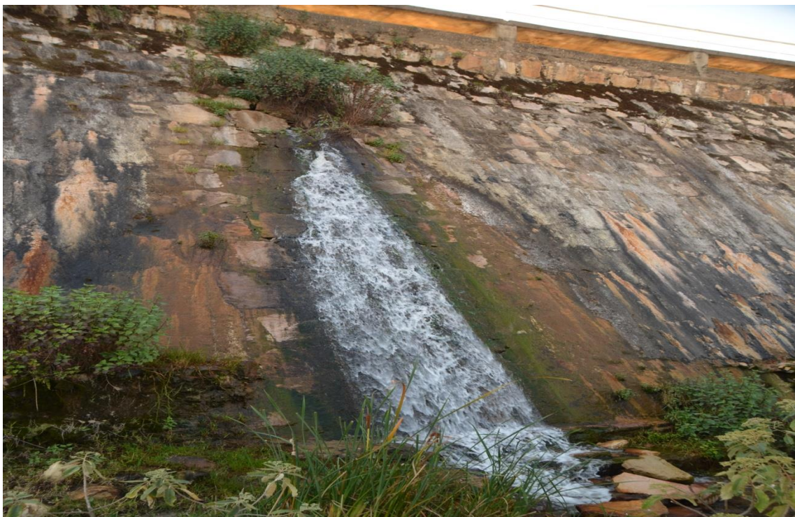
Figura 3.9. Vista de jusante da barragem apresentando fissuras cada vez maiores (30/06/2015).
