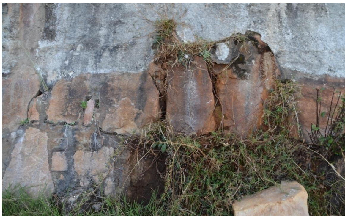
Figura 3.13. Setor da barragem apresentando fissuras sem argamassa.
