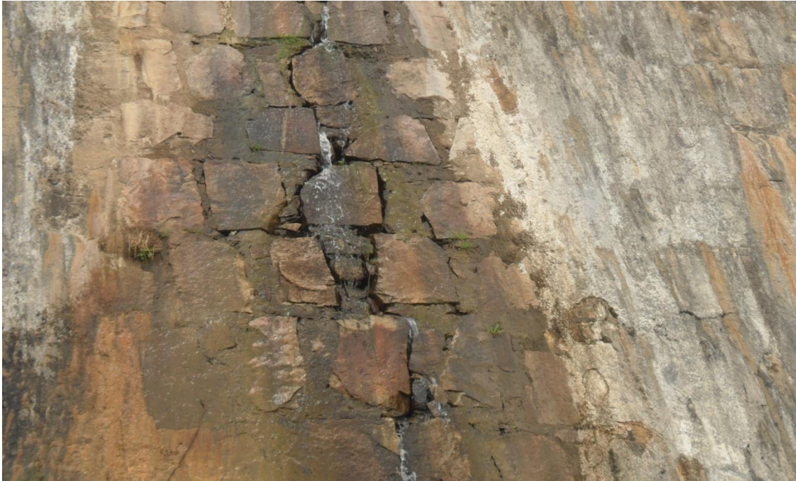
Figura 3.8. Barragem apresentando fissuras preocupantes (30/11/2014).
