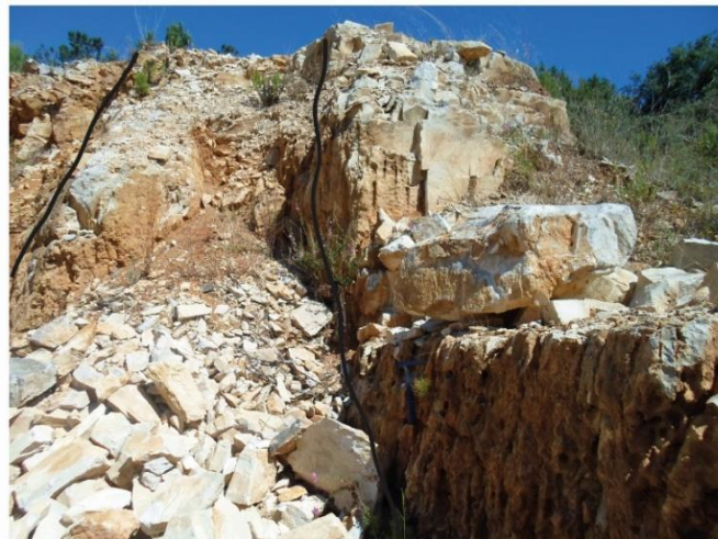
Fendas de carsificação associadas a caixa de falha - pedreira - Pena Junho de 2015
