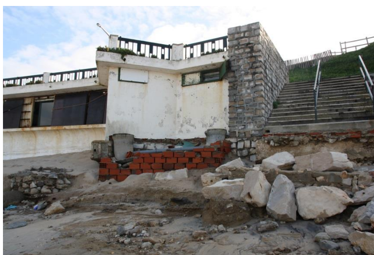
Figura 42 - Exemplo dos danos em S. Pedro de Moel
