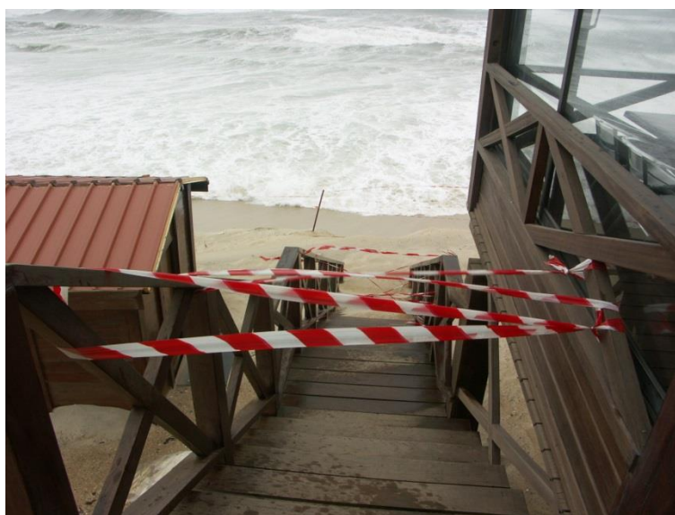
Figura 40 - Danos em escadaria de um apoio de praia
