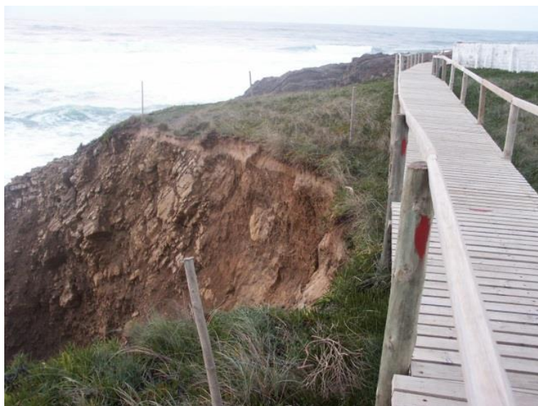
Figura 51 - Fotografias de um movimento de massa em vertente na arribada a sul do farol Fonte: Arquivo fotográfico do Serviço Municipal de Protecção Civil da Marinha Grande
