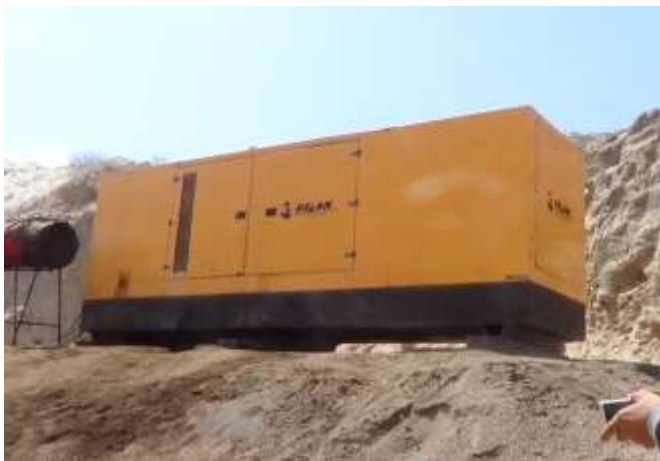
Figura 4.9 - Aspecto do grupo gerador da pedreira Urbipedras.
