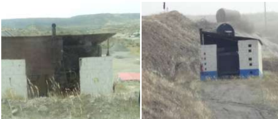
Figura 4.20 - Grupo Gerador de 800kva, para fornecimento de energia eléctrica à pedreira e central de betuminoso.
