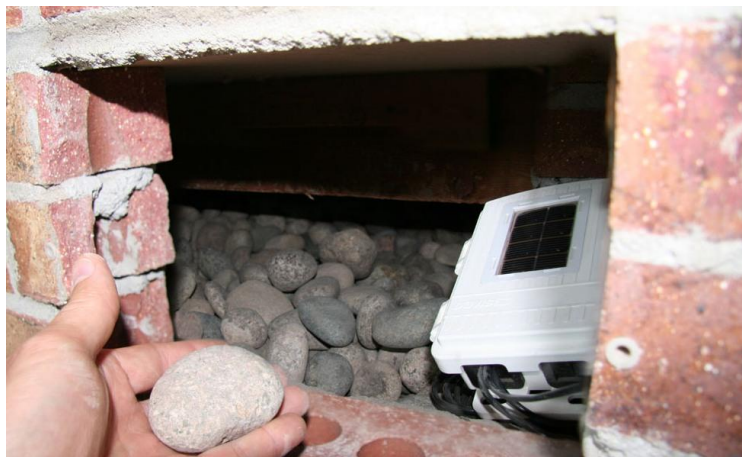
Figura 2.3 – Compartimento com pedras usadas para armazenar calor (Santos 2012)
